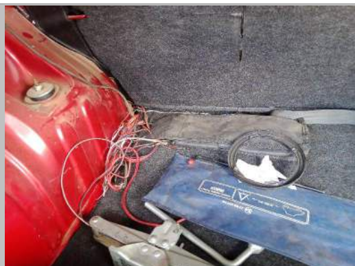
Loose sound wiring
